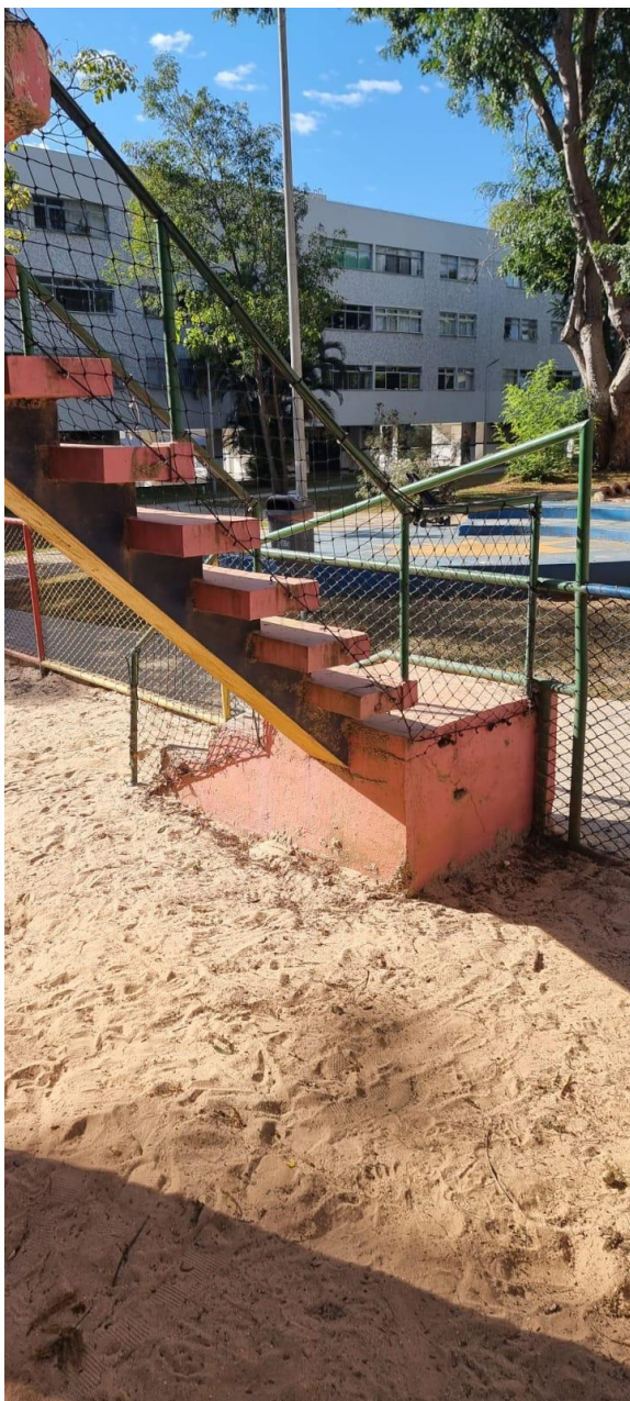
Foto 4: Escada sem guarda-corpo e degraus irregulares
