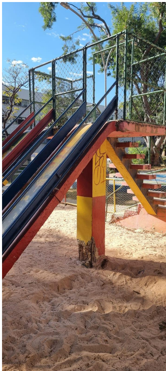
Foto 5: Coluna principal do escorregador com apodrecimento
