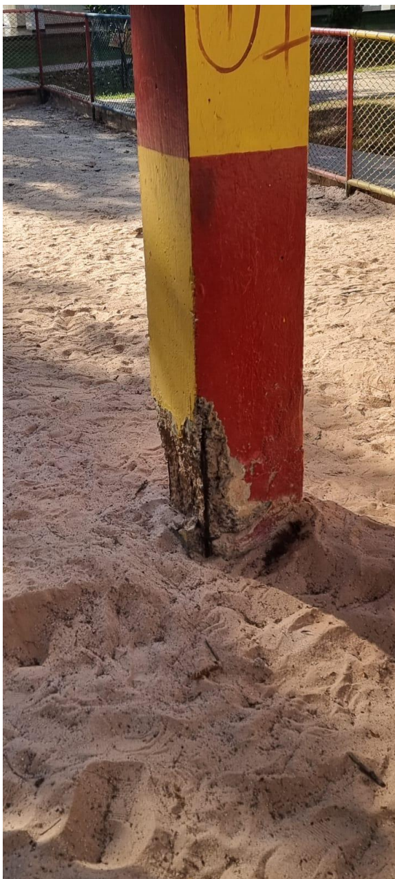
Foto 6: Close-up da base apodrecida da coluna.
